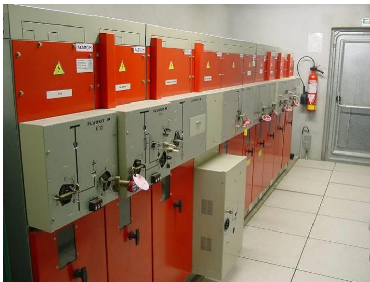
Intérieur d'un poste de livraison
